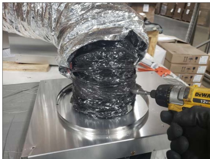
Figure 2.16, Vis dans le revêtement intérieur
